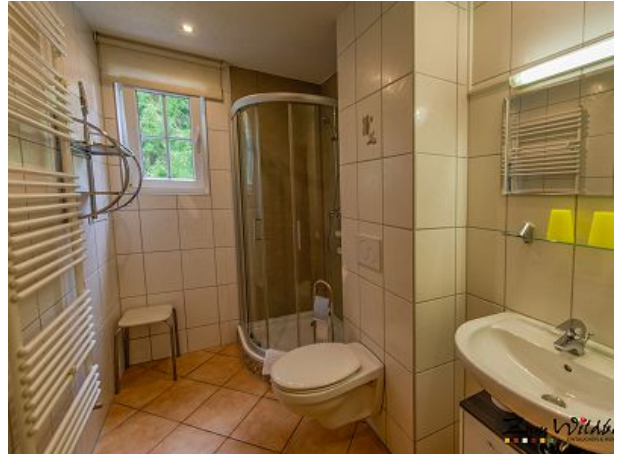
in Bad und WC ist alles Ok
