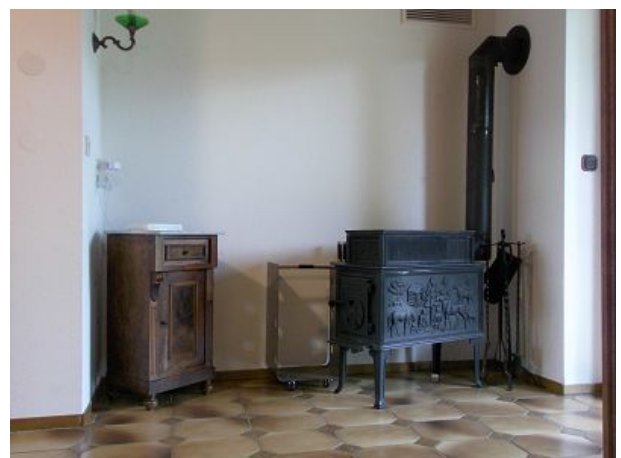
Norwegischer Holzofen im Flur Erdgescho
